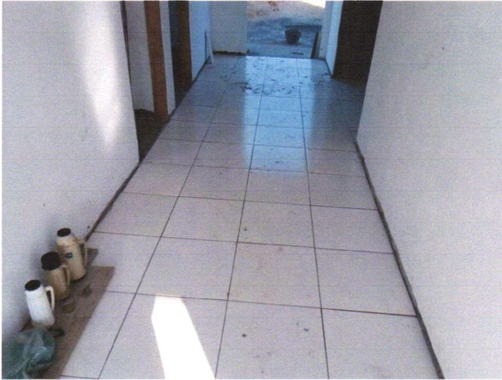
Foto 09 - REVESTIMENTO CERÂMICO PARA PISO COM PLACAS TIPO ESMALTADA EXTRA DE DIMENSÕES 45X45 CM APLICADA EM AMBIENTES DE ÁREA ENTRE 5 M2 E 10 M2. AF_06/2014
